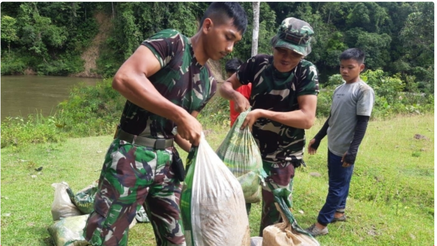
Personil Pos Lumbis Satgas Pamtas Darat RI-Malaysia Yonif 621/Manuntung Laksanakan Karya Bakti pembangunan Jalan Menuju Gereja
